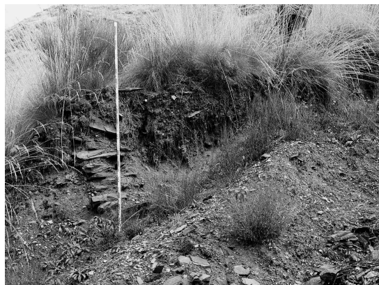
Figura 10. Antiguo muro de balcal roto por un movimiento de ladera cerca del Puerto de la Magdalena. Figure 10. Old wall broken by a landslide, near Puerto de La Magdalena.
