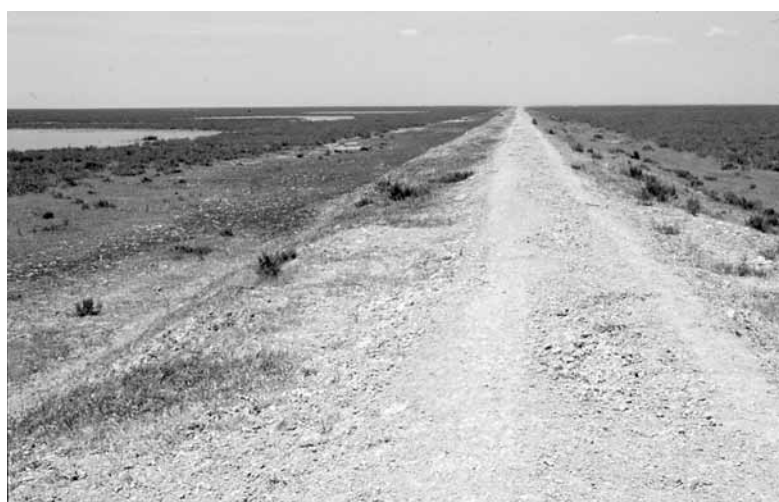
Figura 6. Dique de prolongación de la “Montaña del Río” tras el desastre de la mina de Aznalcóllar. Figure 6. Dock of prolongation of the “Mountain of the River” after the disaster of the mine of Aznalcóllar.
