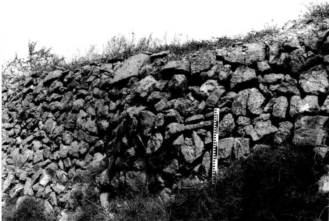
Fig. 6. Tramo de ribazo con manifestación crítica de abombamiento (Strech of bank with critical manifestation of sagging)
