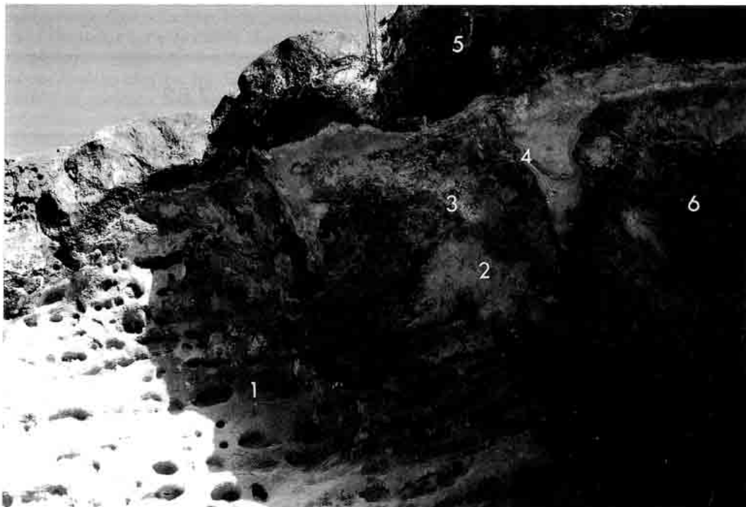
Foto 1. Aspecto general de la parte izquierda del abrigo, en la que se observan diferentes microformas y productos de alteración. 1: Tafoni. 2: Escamas. 3: Eflorescencias. 4: Concreciones carbonatadas. 5: Costras de alteración. 6: Pátina de ennegrecimiento. El voladizo se encuentra afectado por un sistema de fracturas a través de las cuales percola el agua. En la parte inferior derecha se observan algunos grabados. (Left side of the Cogul cliff-foot cave where several weathering products can be observed: 1: Tafoni. 2: Flakes. 3: Salt crystals. 4: Carbonate concretions. 5: Weathering crust. 6: Black rock coating or varnish. The caprock is affected by joints through which water can percolate. Note the rock carvings on the lower-right side).
