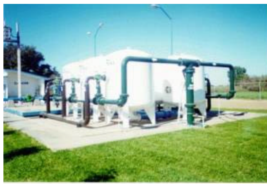
Figura 13. Planta potabilizadora “La Platanera”.
