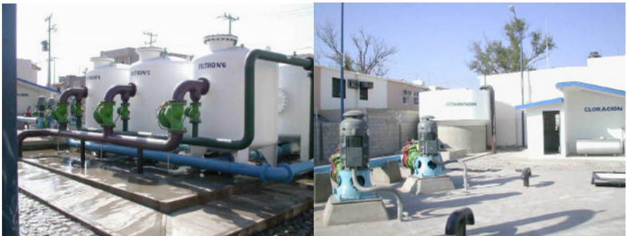
Figura 15. Filtros (izquierda), sedimentador, bombas y cuarto de cloración (derecha) de la planta potabilizadora “Campaña II”.
